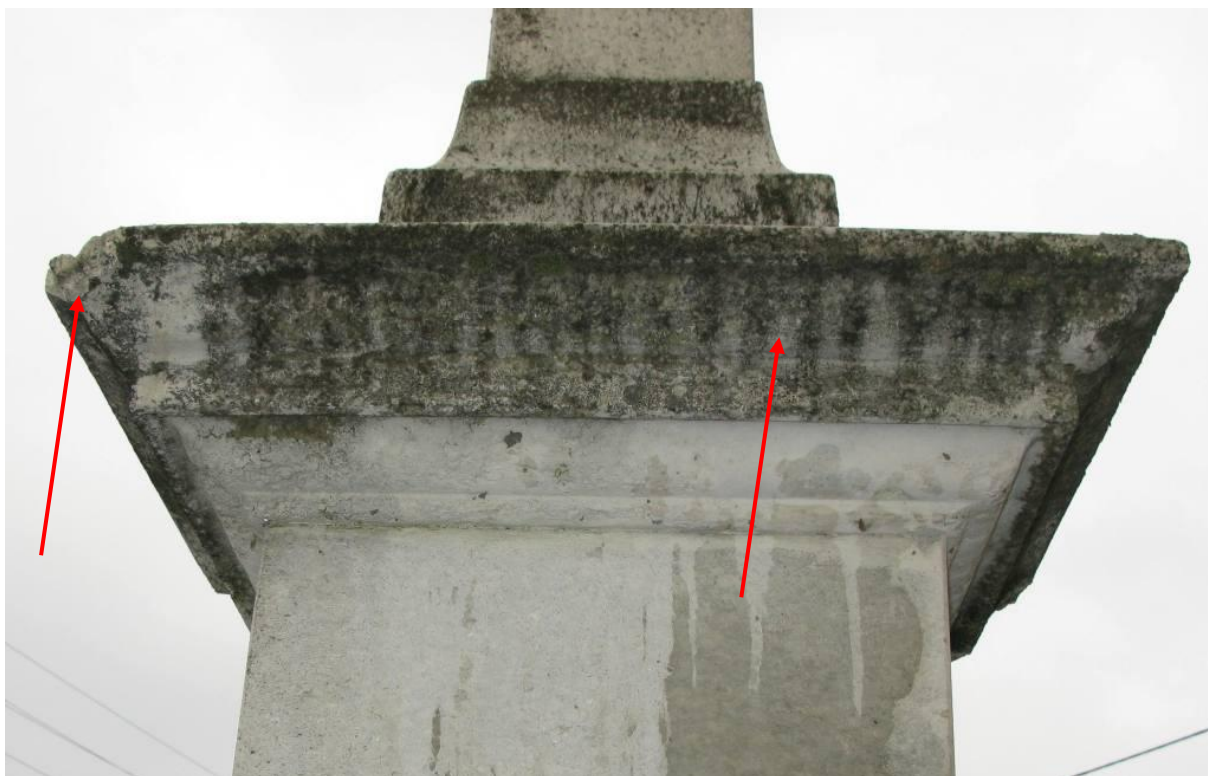
9. Kříž u kaple – detail střední části, římsa, poškození - znečištění tmavými deposity z ovzduší (vlivem srážkového deště) a biologické poškození.
