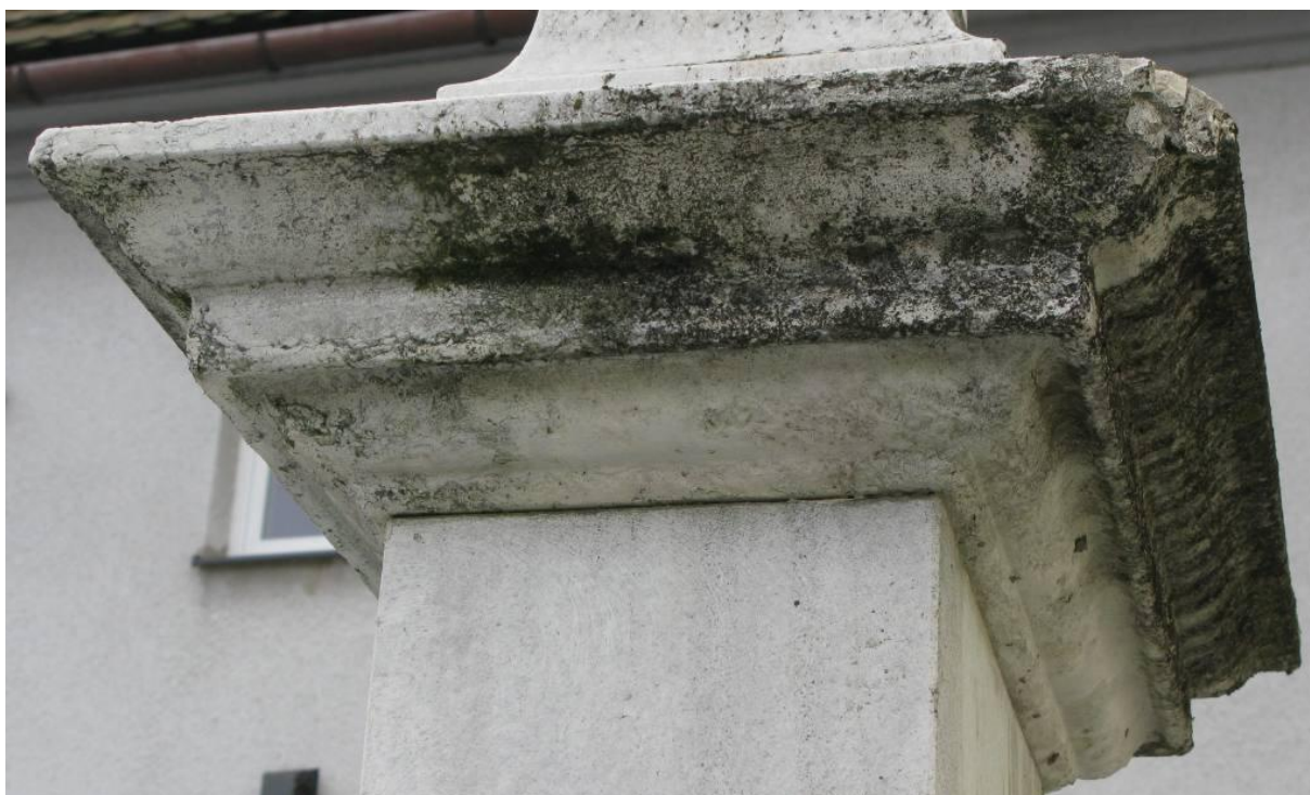
10. Kříž u kaple – detail střední části, římsa, poškození - znečištění tmavými deposity z ovzduší (vlivem srážkového deště) a biologické poškození, vyžilé spáry.
